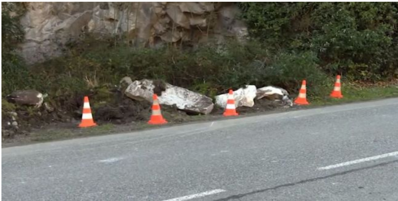
Le 6 novembre, des éboulements avaient détruit le cimetière./ Photo DDM.
