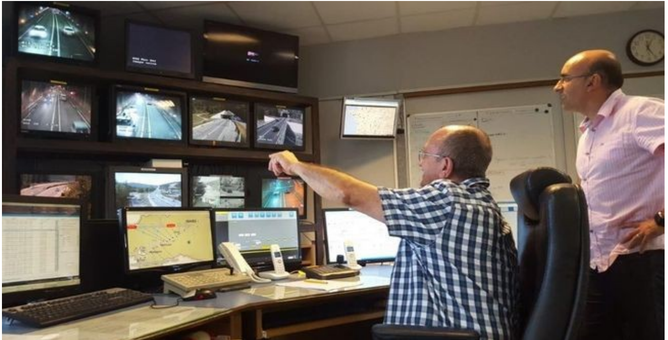
Le centre de contrôle et de gestion du trafic de Saint-Paul-de-Jarrat, au sud de Foix./Photo DDM, L.G.
