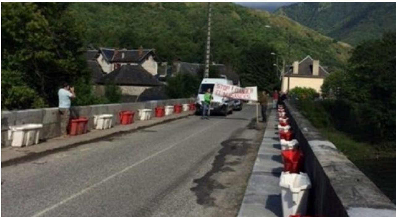
Les manifestants craignent pour la sécurité des personnes et l'état du Pont de Fos déjà très vétuste./Photo DDM, C.T
